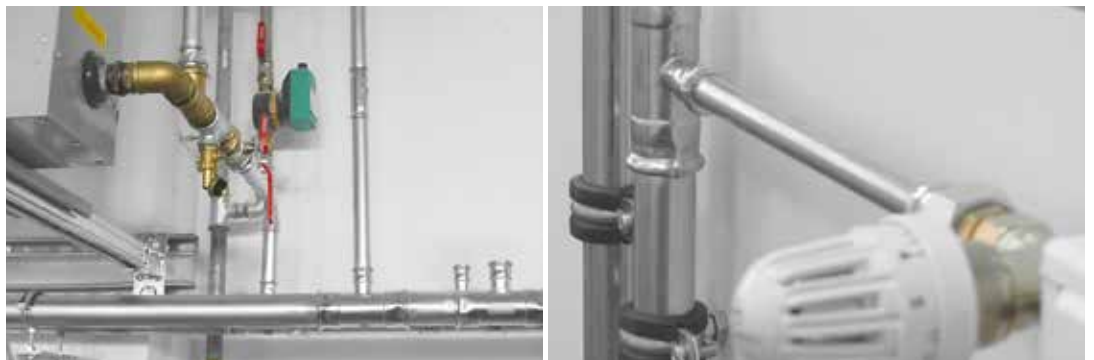
KAN-therm Steel sistēmas instalāciju piemēri
